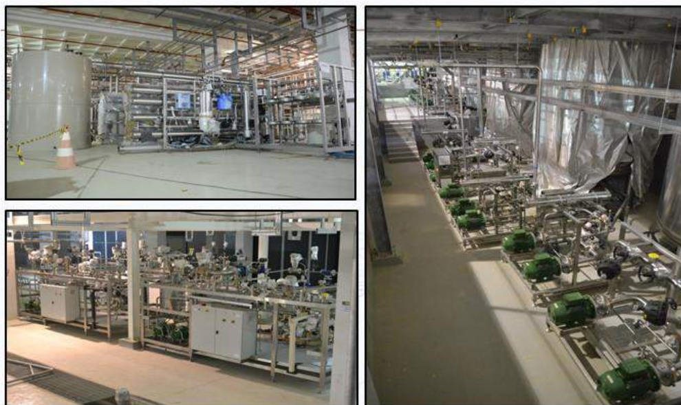
Imagem 10 - Sistemas instalados no subsolo do bloco B02 da fábrica da Hemobrás em Goiana
