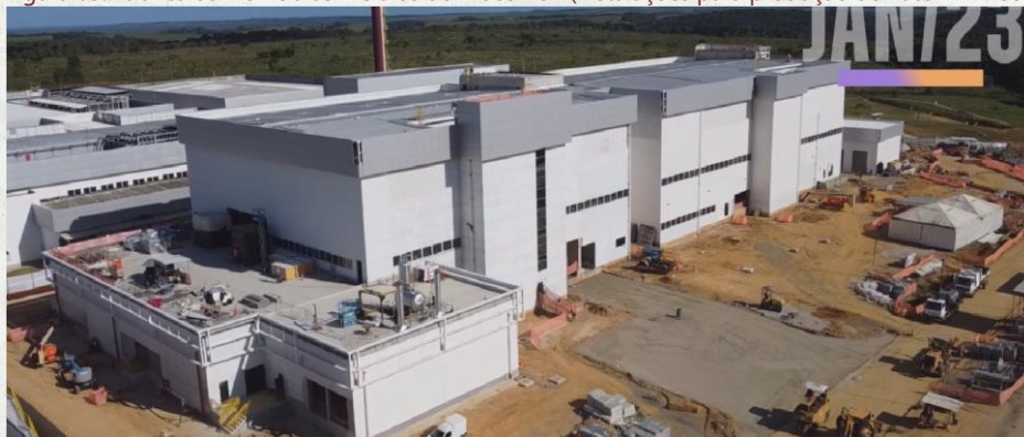
Figura 05. Fábrica da Hemobrás – Obras do Bloco B07 (instalações para produção do Fator VIII recombinante).
